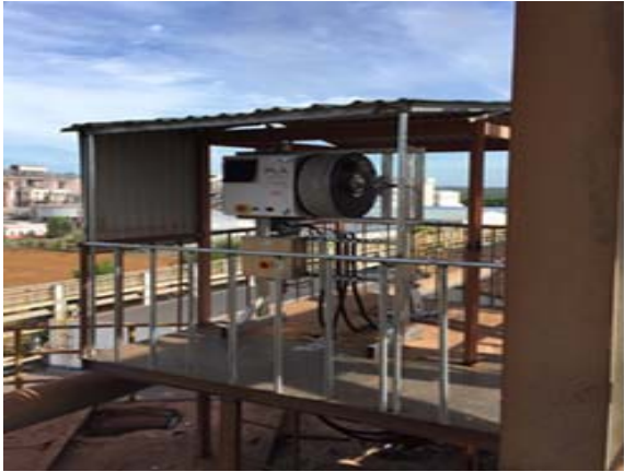
Hệ thống thiết bị đo Smart Dive được lắp tại nhà máy Alumina Lâm Đồng
