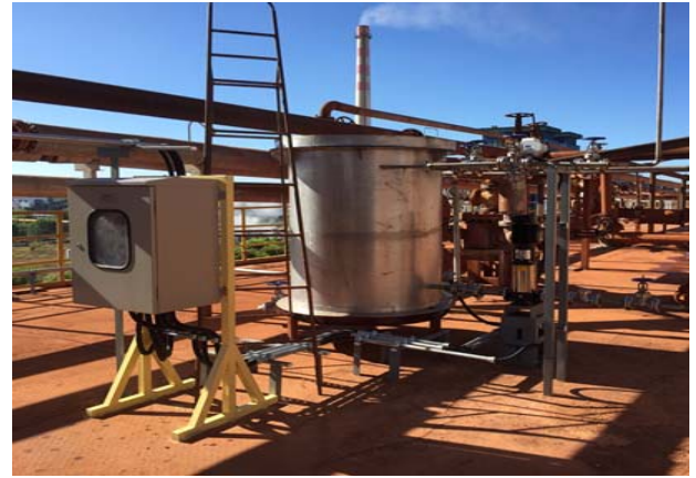
Hệ thống chuẩn bị nước vệ sinh được điều khiển tự động
